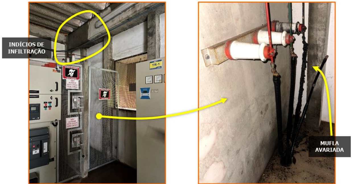
Figura 1 - Registro de infiltração e avaria em mufla na SE-16 (CCS). Fonte: Empresa acionada pela UFSC – Contrato 53/2023.
