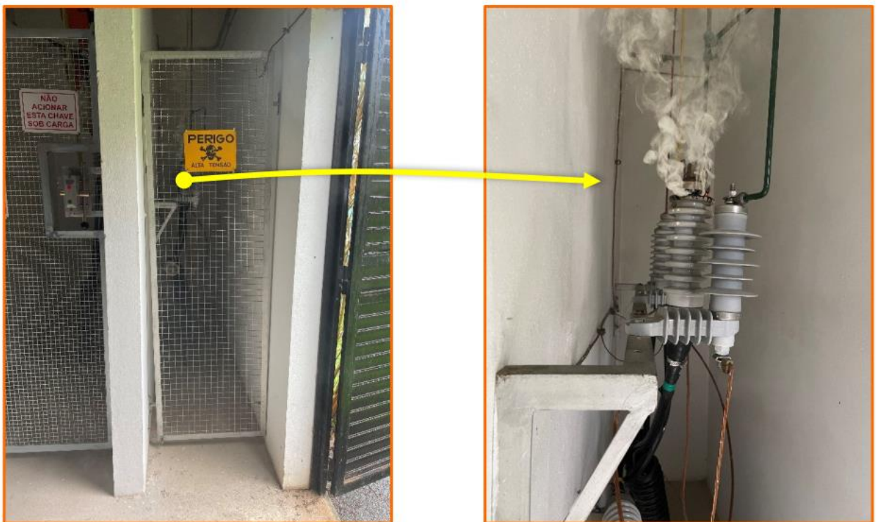
Figura 2 - Registro de mufla em condições precárias na SE-26 (EMC). Fonte: Empresa acionada pela UFSC – Contrato 53/2023.
