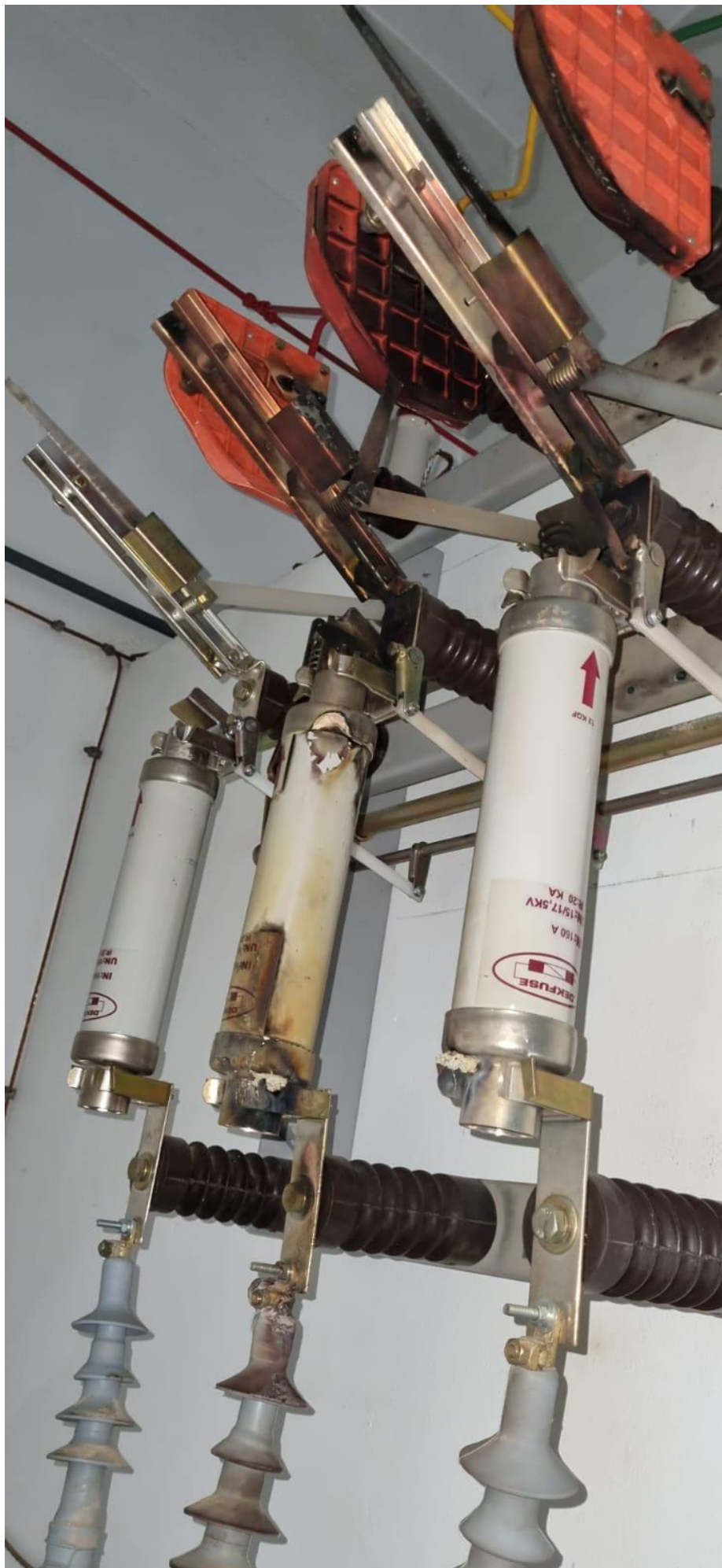
Figura 3 - Registro de fusível avariado na SE-16 (CCS). Fonte: Equipes da PU.
